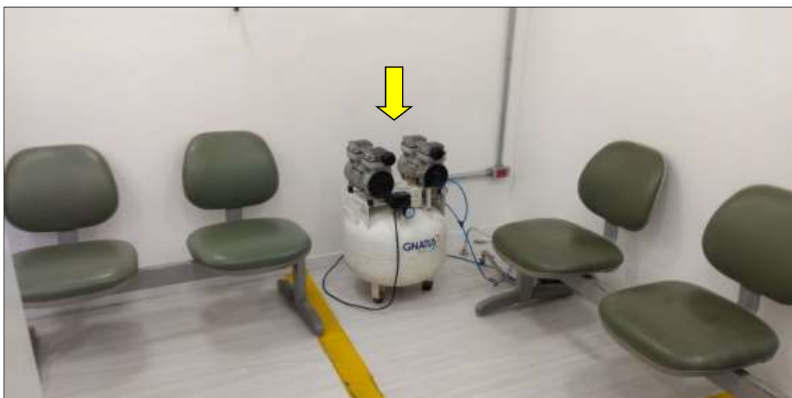
Foto 04: Compressor instalado de forma irregular em sala de descanso destinado aos Servidores.
